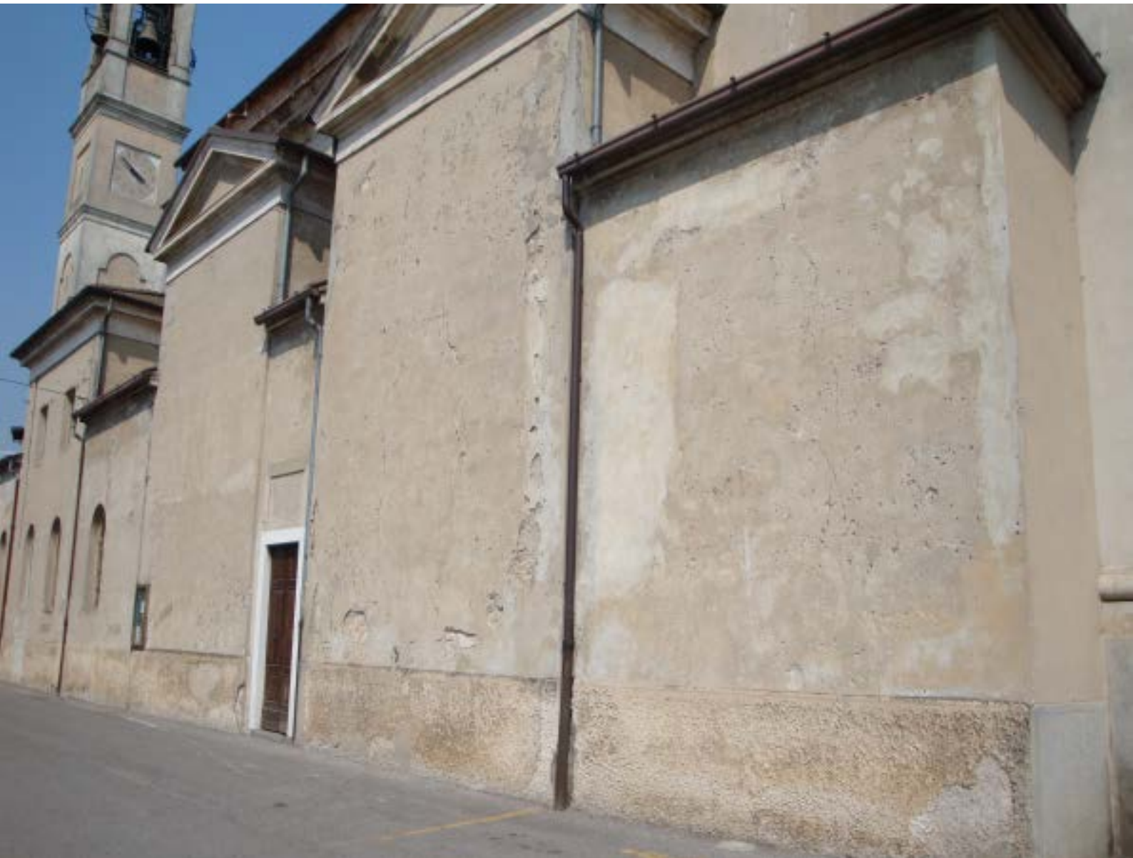
Le superfici murali esterne della chiesa prima dell'intervento
