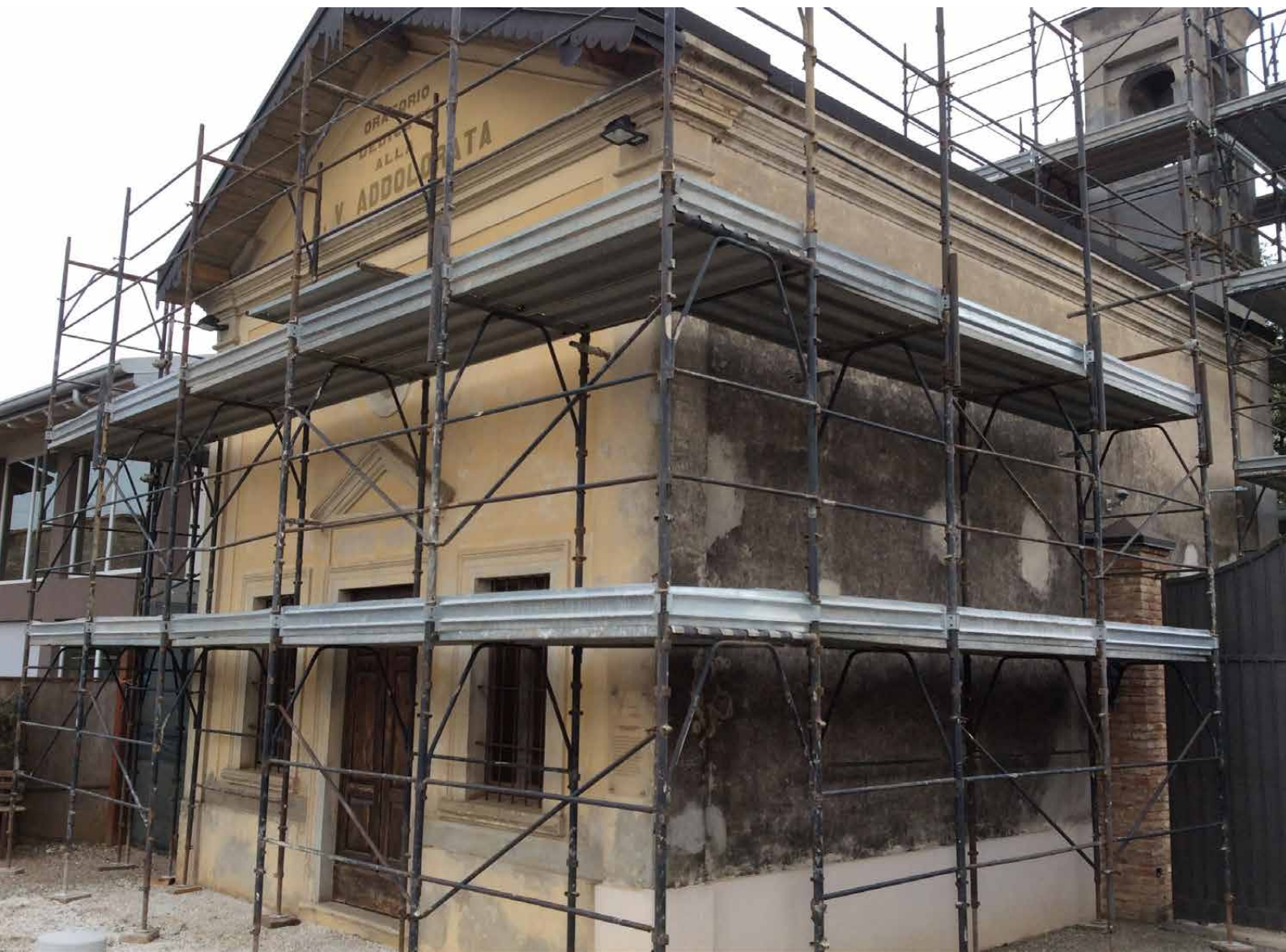
Lo stato delle facciate prima dell'intervento
