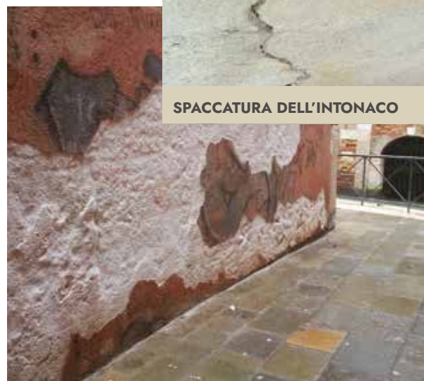
EFFLORESCENZE E SUB-EFFLORESCENZE SALINE
