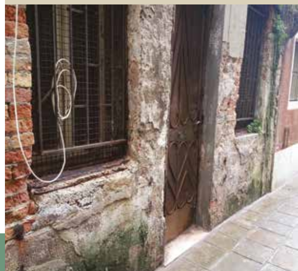
DANNI PROVOCATI DALL'UMIDITÀ DI RISALITA
