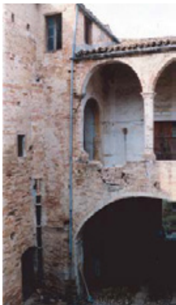
Da questa foto si nota la fatiscenza dei muri perimetrali
