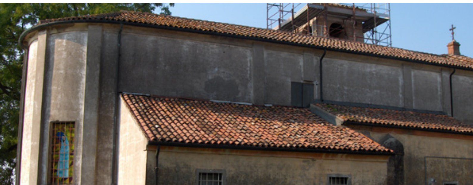
Parte posteriore della chiesa, lo stato di degrado delle finiture è evidente
