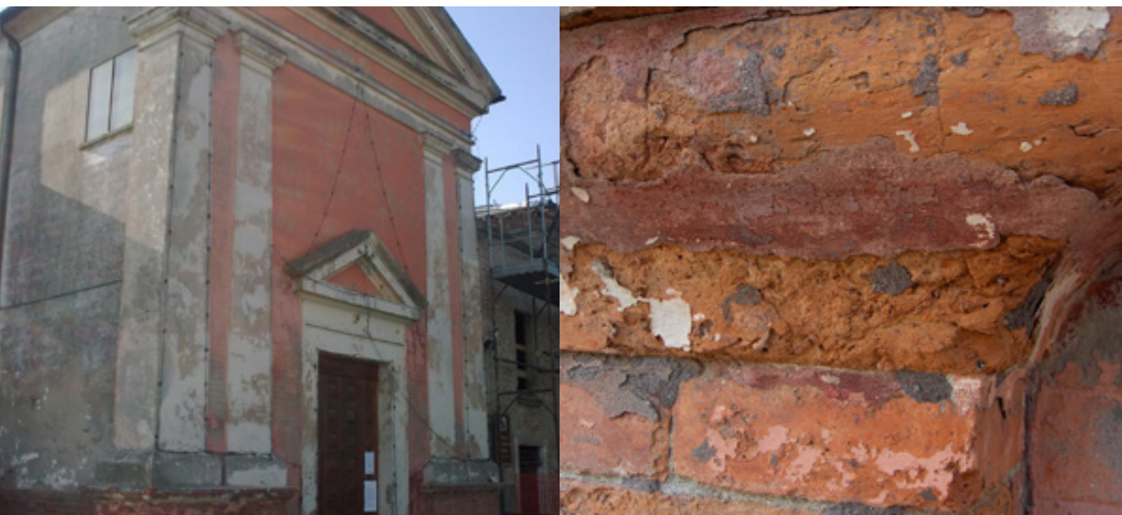
Lo stato della chiesa prima dell'intervento e dettaglio delle murature ammalorate
